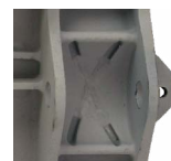
Canal de bolsillo desgastado
